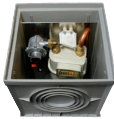
Solution avec compteur GAZ, un utilisateur
