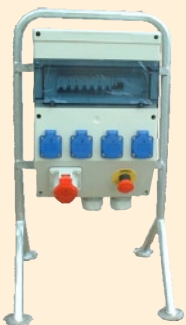
Exemple de coffret pied de grue avec alimentation de la grue par prise: 6827116F ou bornier: 647A3501F )
